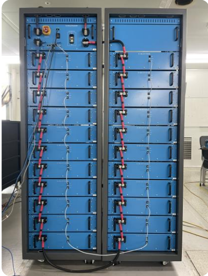
랙 2기 병렬 설치
